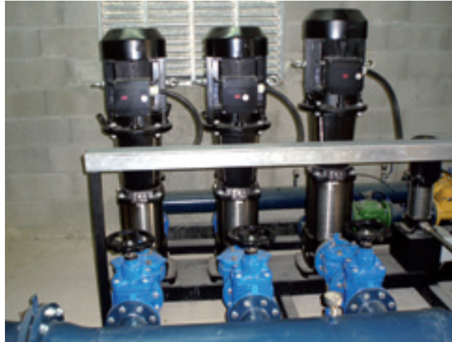
Figura 2.11. Bomba centrífuga de eje vertical multietapa. Olot (Girona). Fuente: Fotografía de M. Salgot (2015).
