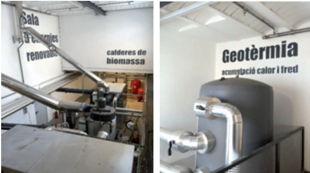
Figura 3.15. Caldera de biomasa y acumulador de calor y frío.
