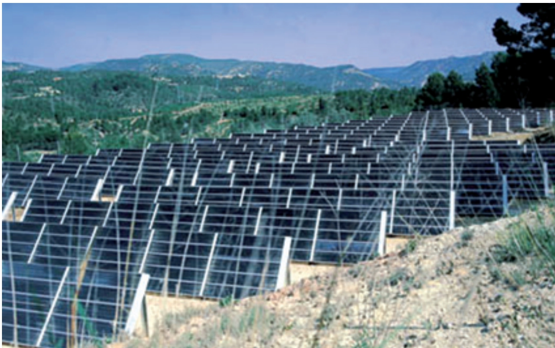
Figura 1.17. Placas fotovoltaicas para la captación de energía solar. Fuente: Instituto para la Diversificación y Ahorro de la Energía (consultado en 2016).
