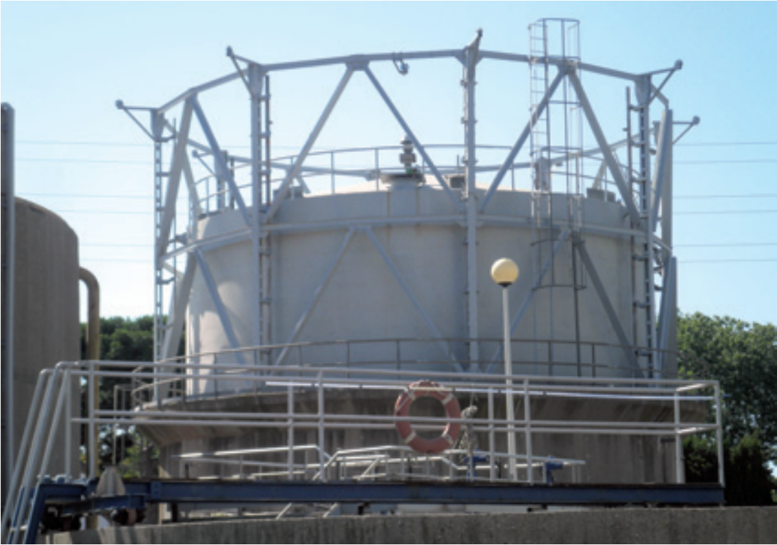
Figura 2.17. Depósito de gas generado en la EDAR de Gavà-Viladecans, Barcelona (España). Fuente: Fotografía de M. Salgot (2011).
