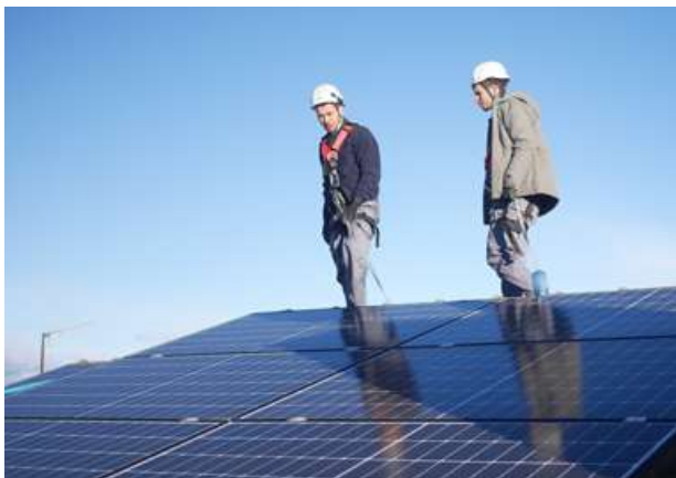
Instalación en un centro residencial de la Fundación San Martín de Porres en Madrid.
