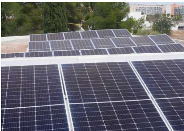
Instalación en el Hogar Nuestra Señora de los Desamparados de Cáritas Valencia.
