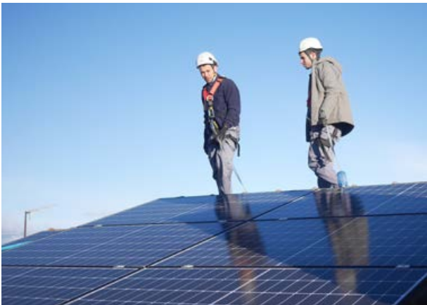
Instal·lació en un centre residencial de la Fundació San Martín de Porres a Madrid.
