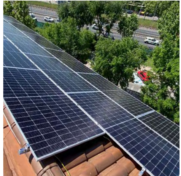
Plaques de la instal·lació al carrer Aloses de Getafe.
