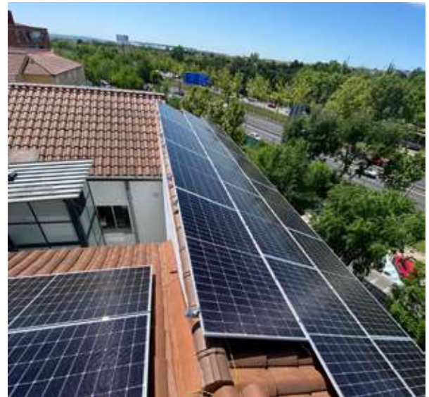
Instalación solar en Getafe.
