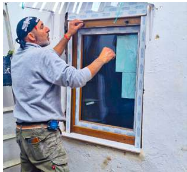
Cambio de ventana en una vivienda en Paiporta dentro del programa de rehabilitación energética.
