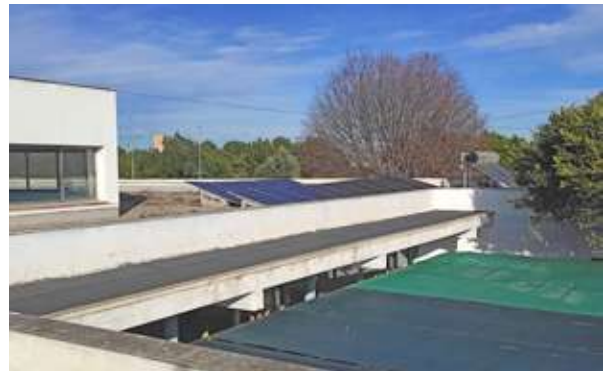
Instalación de placas fotovoltaicas en el CEIP Sanchís Almiñano de Alaquás (Valencia).
