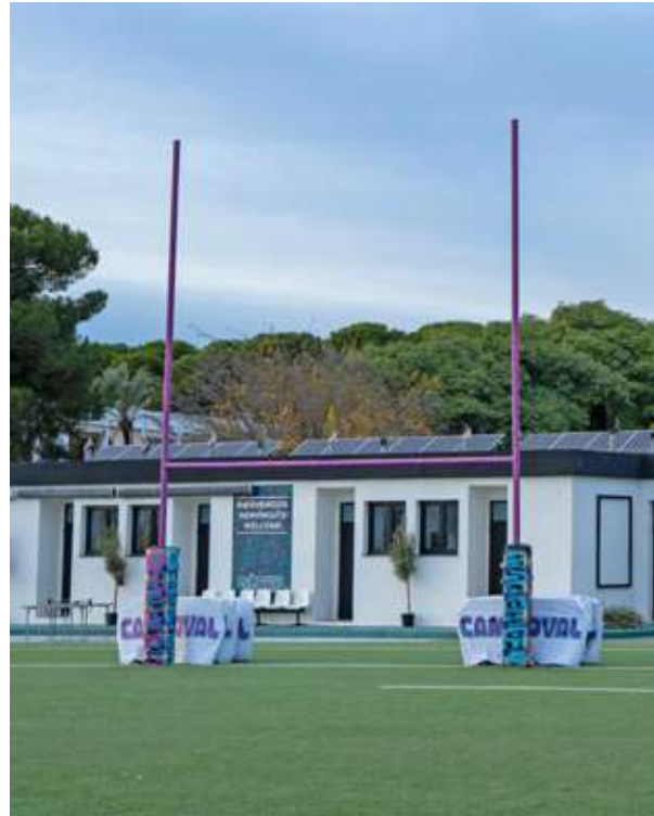
Instalación solar en Campoval en Picanya, Valencia.
