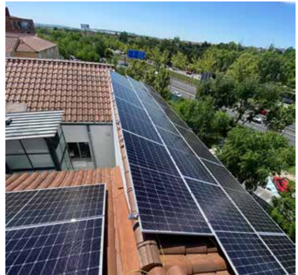
Instal·lació solar a Getafe.
