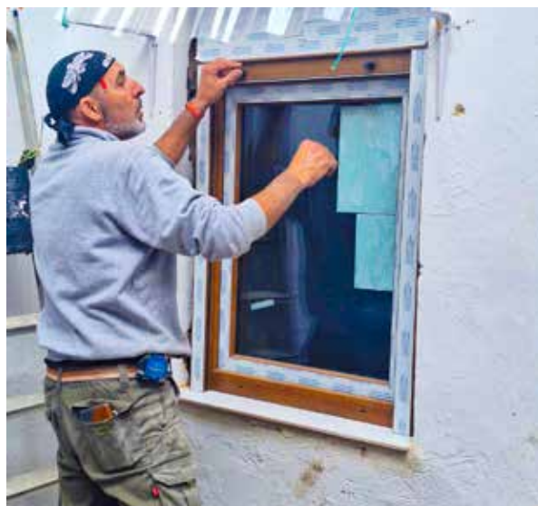
Canvi de finestra en un habitatge a Paiporta dins del programa de rehabilitació energètica.
